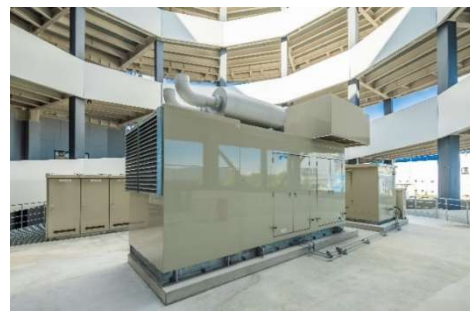
72 時間対応非常用発電機
