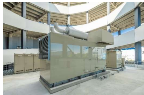
72 時間対応非常用発電機
